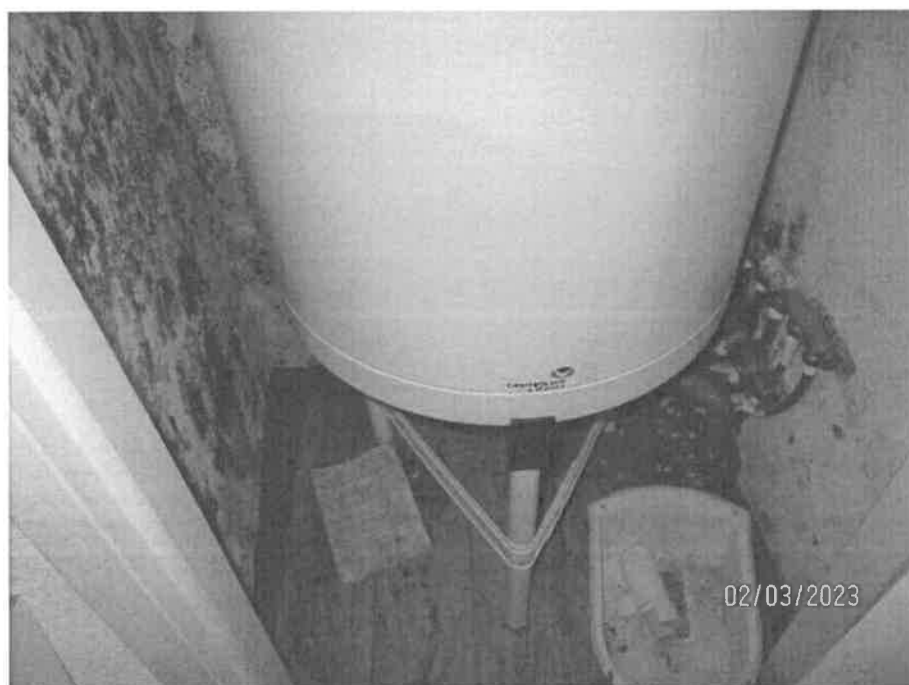
Paroi chauffe-eau pièce face entrée
