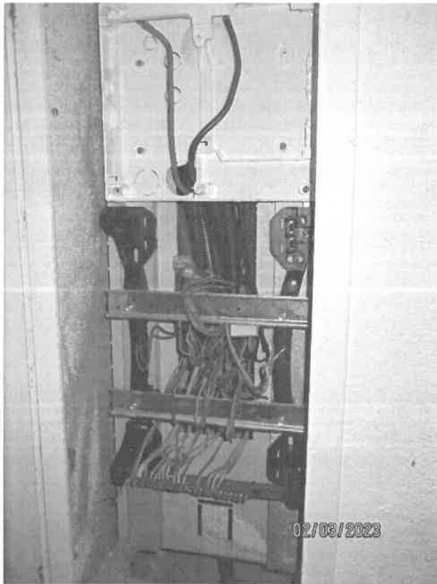
Coffret électrique hall entrée
